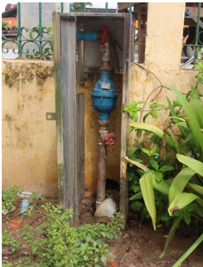
Detta lär ska vara inkommande vatten till skolan för döva eller blinda barn i Phnom Penh. Den blå installationen är ett vattenfilter för att säkra rent dricksvatten.
